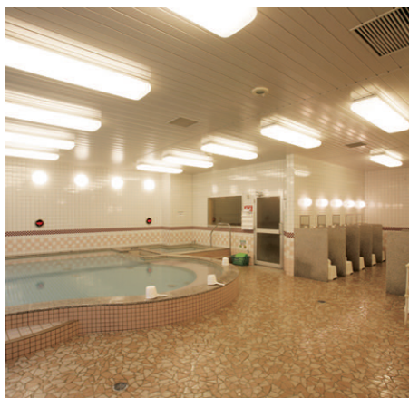
温浴施設の照明：高湿度環境用直付器具と浴室灯を設置。電球色で心安らぐ空間を形成
