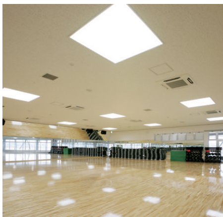
スタジオの照明：昼白色の105WHfコンパクト形蛍光ランプ4灯用カバー付埋込器具を整列配置し、活動的な雰囲気を作成
