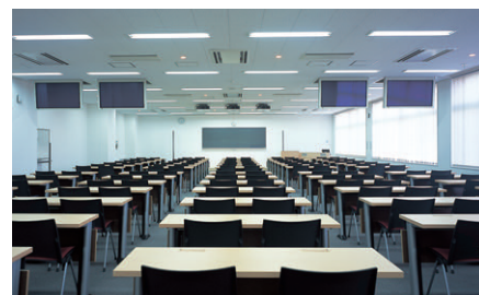
最新設備のプロジェクタを備えた大会議室には、FHF32Wランプフリー埋込下面開放器具を整列配置
