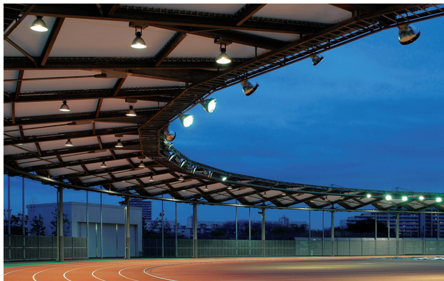
ナショナルトレーニングセンター「陸上トレーニング場」屋根付400mトラック及びフィールドの照明 屋根付トラックの照明はMF400W高天井用反射器具、フィールドの照明はM700W・MF400W投光器を採用
