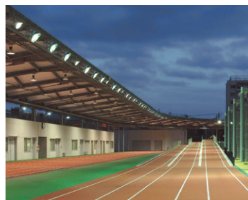
傾斜走路の照明
