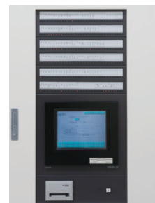
照明制御装置 中央監視室に置かれた照明制御装置MESL主操作盤
