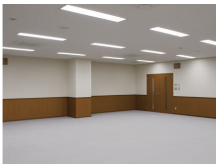
局長室 落ち着いた雰囲気のある局長室にはHf32W2灯用パッフル付埋込器具20台を等間隔で配置して、SESアかりセンサを窓際に2台配置している
