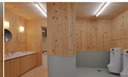
人感センサによりON・OFF制御したトイレの照明
