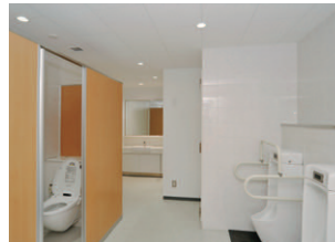
理学部E館トイレのLED照明
