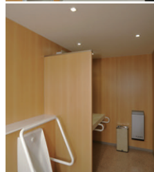
本部1号館トイレのLED照明
