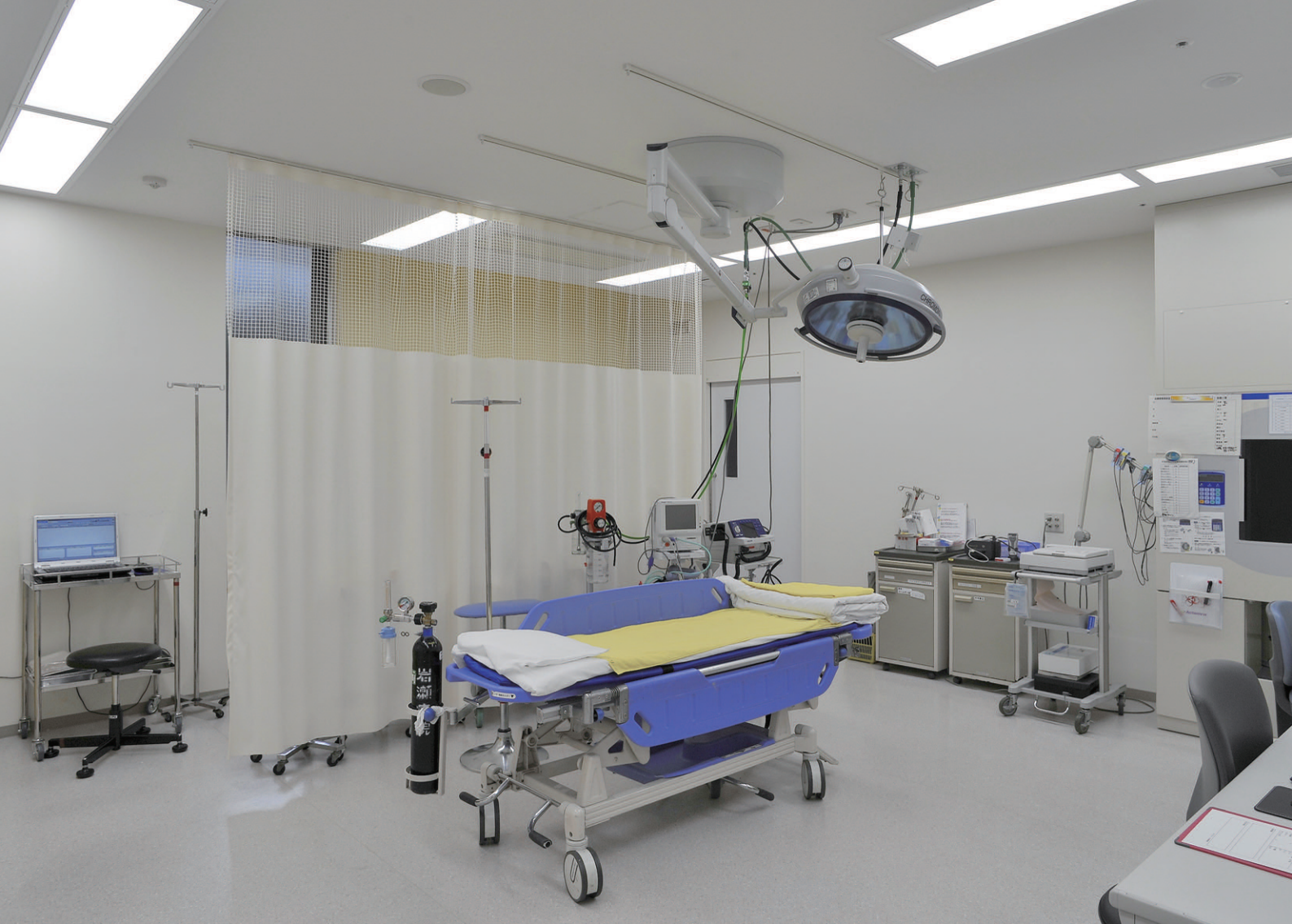
救急処置室の照明 蛍光灯埋込カバー付器具調光形を採用し、治療台を囲む形で配置。患者ごとの容態に応じた調光が可能
