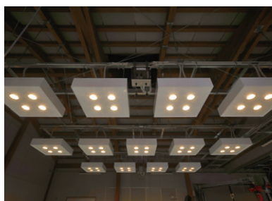
LED照明内蔵ボックスは1槽当たり13基を配置
