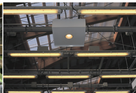
種苗生産棟水槽上部の照明配置の状態
