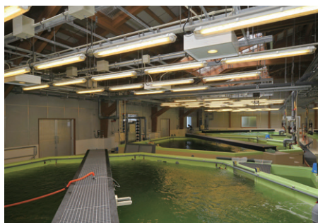
FHP105W耐食耐酸性器具と1灯用LED照明内蔵ボックスを配置した種苗生産棟水槽
