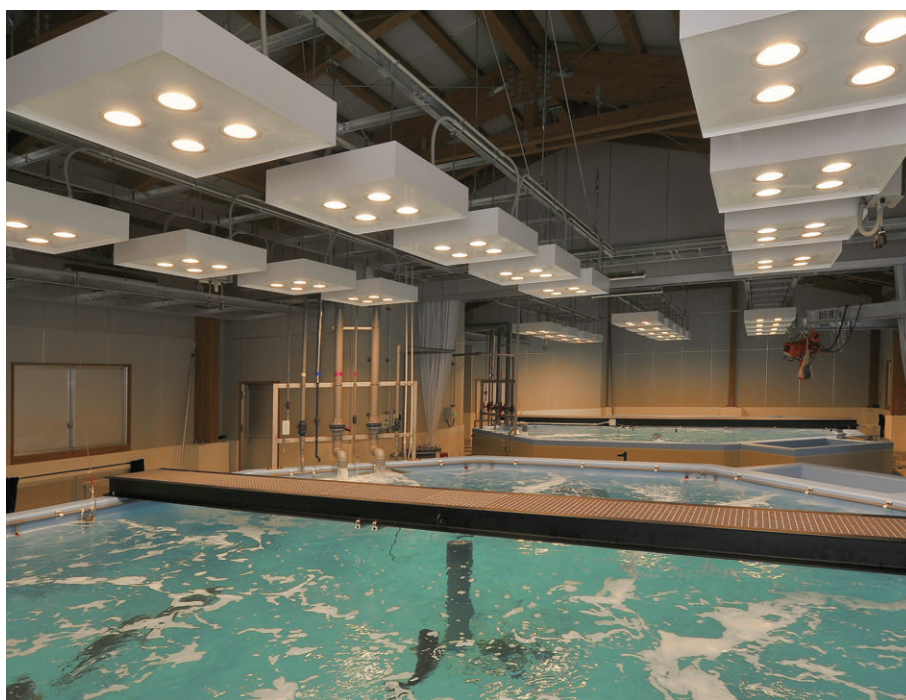
親魚棟水槽の照明 人工的に日の出、日の入りを再現し、採卵時期を調整する4灯用LED照明内蔵ボックスを水槽上部に配置
