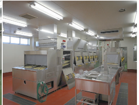
洗浄室のベース照明にも調理室と同様の器具を採用
