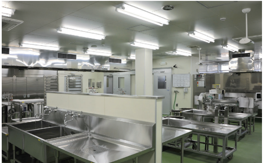
調理エリアの照明 低誘虫チューブを装備した高効率なHf32W高出力蛍光ランプ2灯用防湿防雨形器具を均等配置
