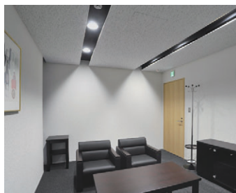
応接室のLED照明
