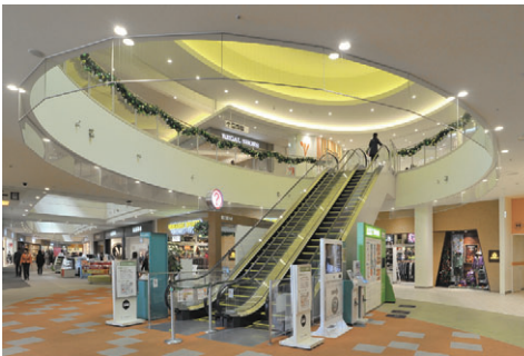
モール部の照明(2) 吹き抜けの2階部分に蛍光灯の間接照明を施し、その周囲にLEDダウンライト6000シリーズを設置
