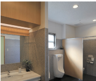
トイレ内の照明にもLEDダウンライトと人感センサーによりON/OFF制御
