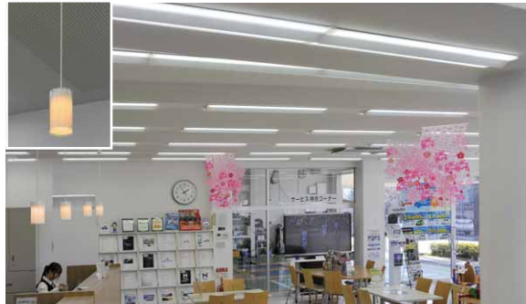
サービスカウンターには薄形LEDベースライトのほか、LED小形ペンダントをカウンター上に設置
