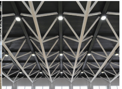
天井トラスに分散設置したLED高天井器具
