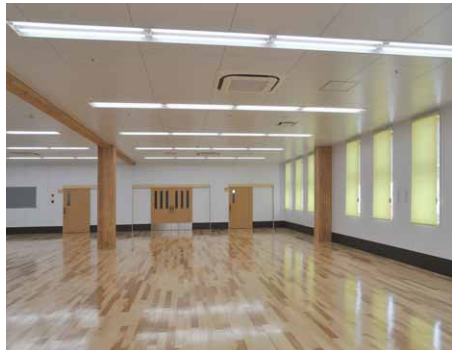
LEDベースライトの連結設置による集会室・訓練室の照明
