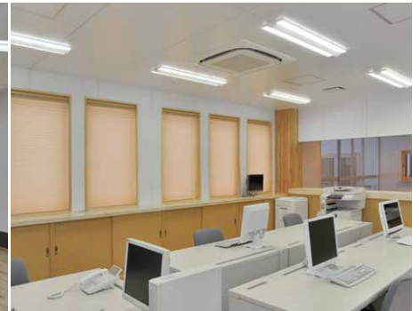
事務室にはLED薄形ベースライトを整列配置
