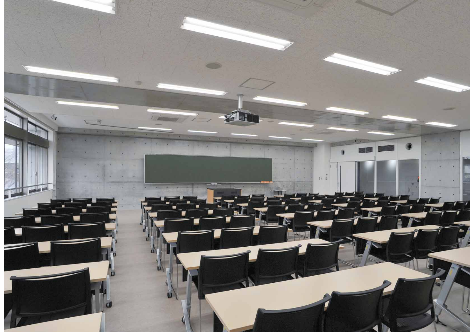
大教室の後方から黒板側方向へ照明を望む 黒板と平行に直管形LEDベースライト埋込形ストレートタイプを整齐配置。点滅スイッチは前列・前窓側・中列・後列に回路分け
