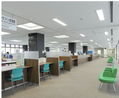
2階窓口業務フロアの光ダクト+LED照明
