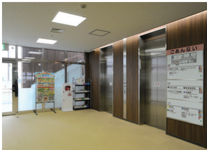
3階エレベーターホールのLED照明
