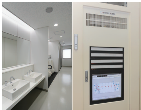
LED照明と人感センサーによる 照明制御システム主操作盤 ON/OFF点滅制御のトイレの照明
