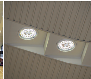
LED高天井器具を2連に設置し、器具下面にはガードを装備
