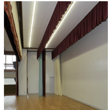
ステージ用には一体形LEDベースライトスリムタイプを設置
