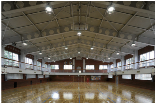
左右対称配置のLED高天井器具をステージ側から出入口側を望む
