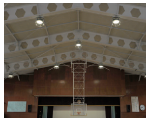
LED高天井器具を配置した天井面
