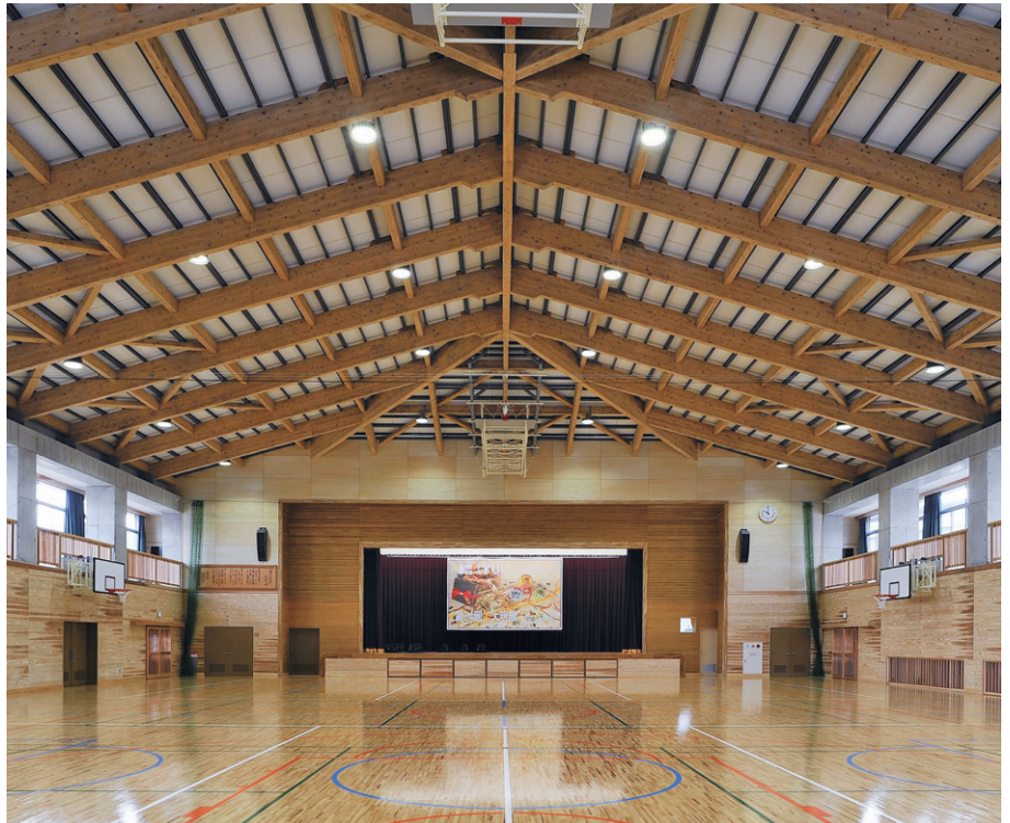
LED高天井器具を木造トラスに千鳥配置で左右対称に設置
