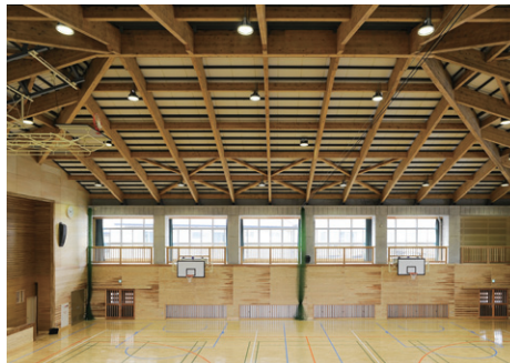
アリーナ側面から望む木造トラスに設置したLED高天井器具
