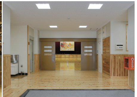
エントランスに採用の蛍光灯スクエア器具
