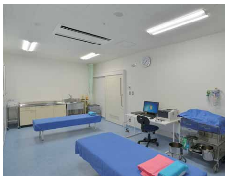
一体形LEDベースライト薄形タイプを採用した処置室
