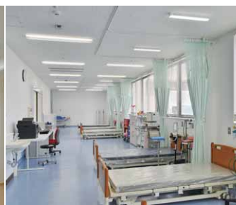
中央処置室のLED照明
