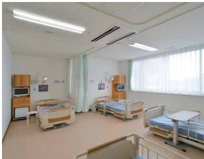
4床病室のLED照明
