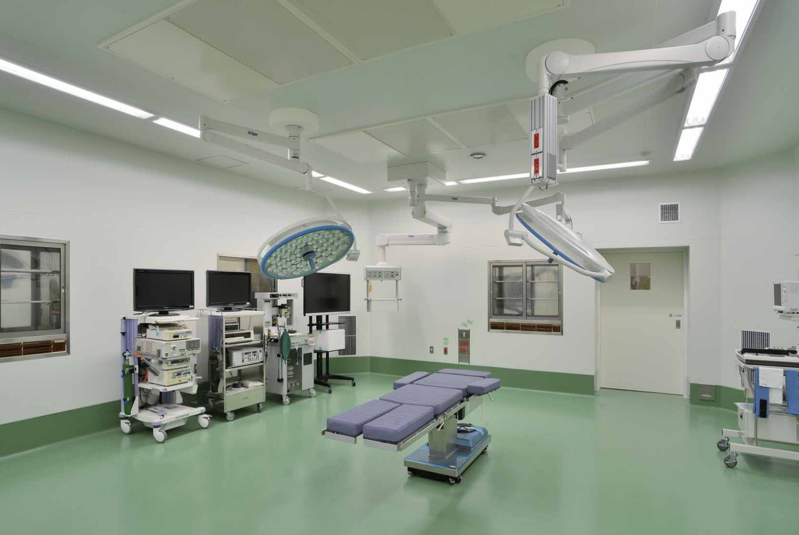
直管形LEDベースライトクリーンルーム用器具飛散防止膜付カバーガラス付を採用した手術部
