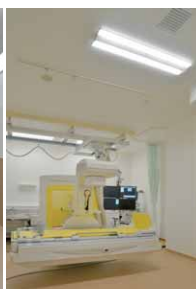
X線検査室のLED照明
