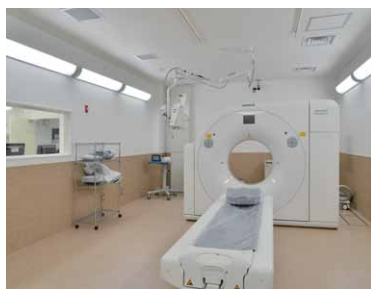
下面カバー付のLED器具を採用したCT検査室
