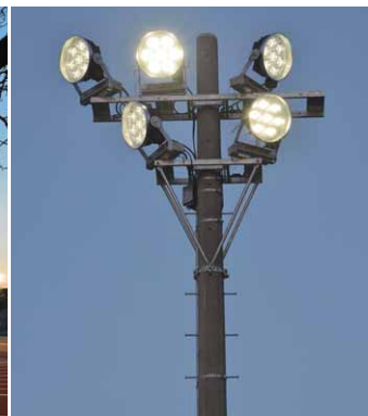
LED投光器5台搭載の照明架台部
