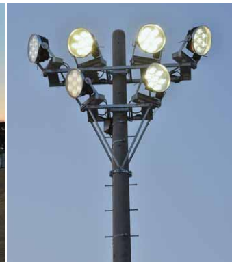
LED投光器6台搭載の照明架台部
