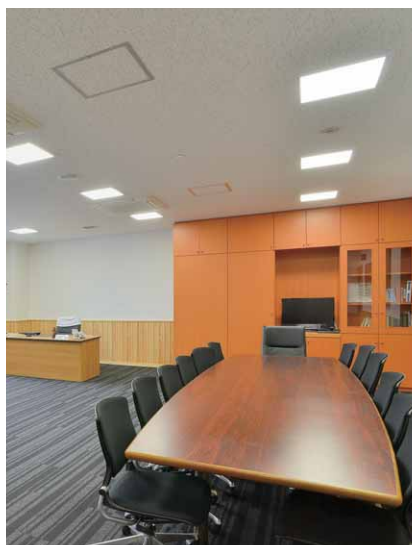
Hf蛍光灯器具スクエアタイプを採用した署長室の照明
