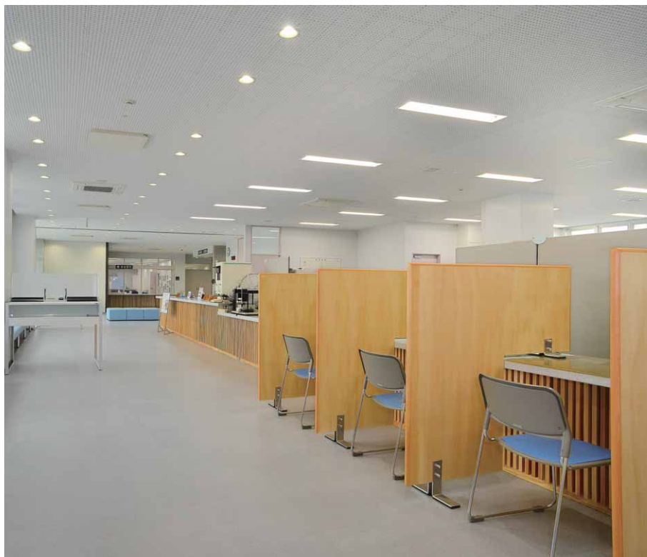
1階交通課の照明 カウンター前はLED一体形ダウンライト、執務室はHf蛍光灯埋込形タイマー内蔵器具を採用
