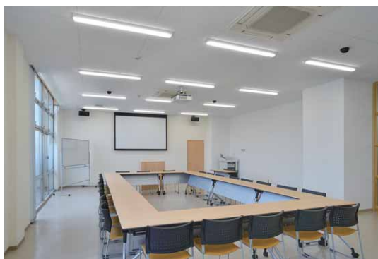
LEDベースライトAQシリーズによる会議室の照明
