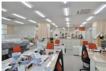
執務室内のLED照明の様子
