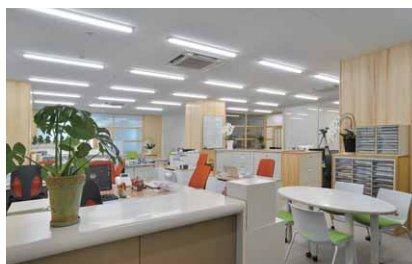
相談室周辺のLED照明
