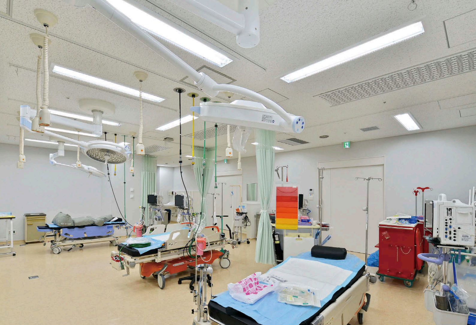
救急患者の処置室にはTENQOOシリーズHACCP・クリーンルーム兼用形器具を採用
