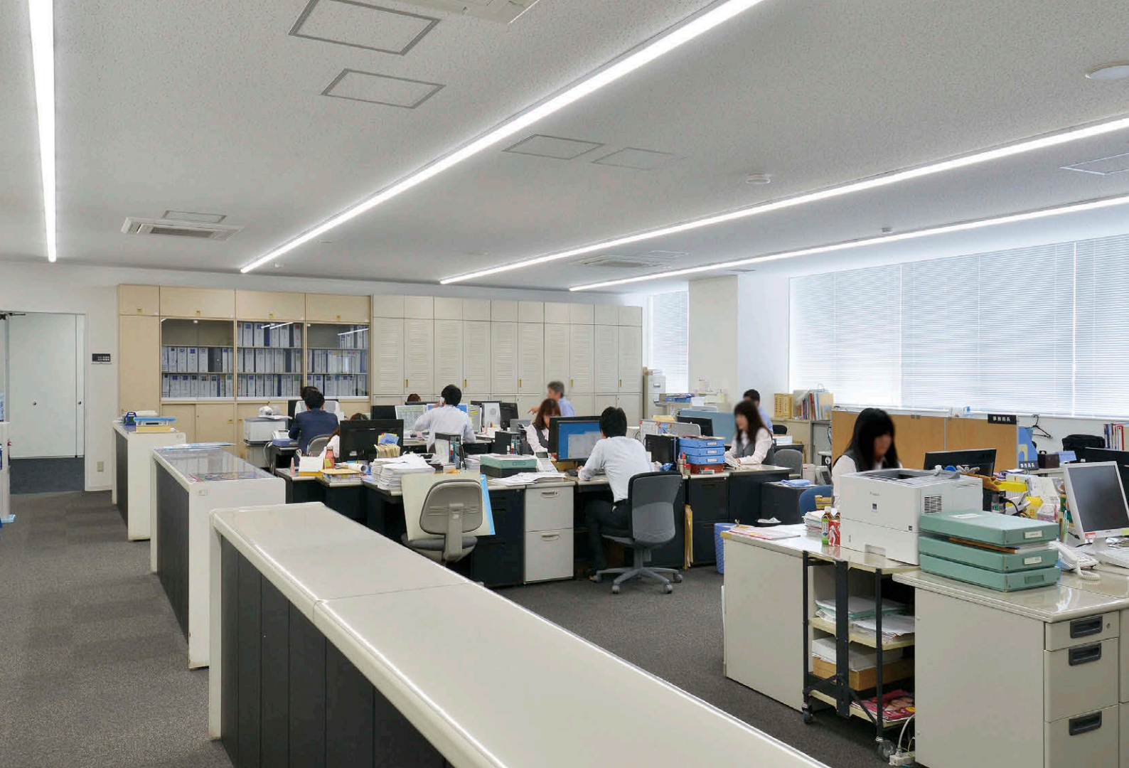
5階、6階に配されている執務室 TENQOOシリーズ直付器具集光タイプの連結設置をライン配置し、快適な執務空間を創出
