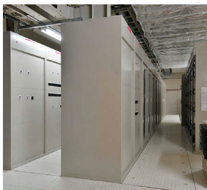
新設したKOBELCO 大ホールの調光器盤
