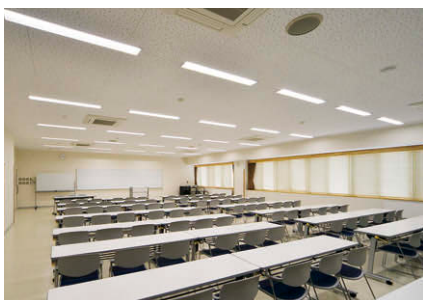
2階会議室のLEDベースライトTENQOOシリーズの 照明
