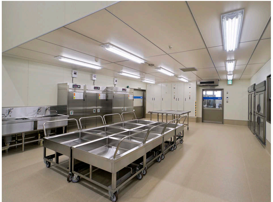
直管形LEDベースライト(直付2灯)のHACCP・クリーンルーム兼用形器具による中学校用ゾーンの調理室
