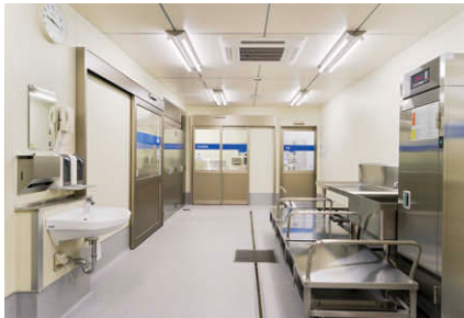
防湿タイプの直管形LEDベースライトによる 中学校用ゾーンの下処理室の照明
