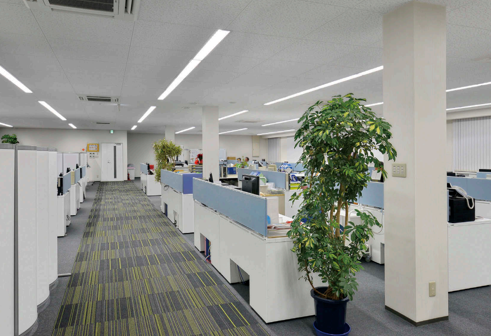
2階営業執務室の照明 TENQOOシリーズ埋込システムアップバップル付を採用し、視作業を十分配慮しつつJIS基準(750ルクス)を満たす机上面平均照度1000ルクスを確保
