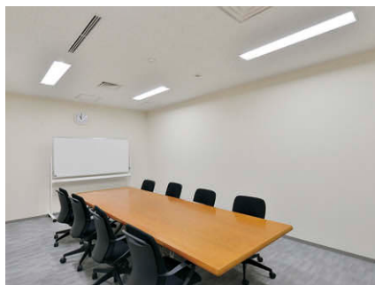
TENQOOシリーズ直付器具による小会議室の照明
