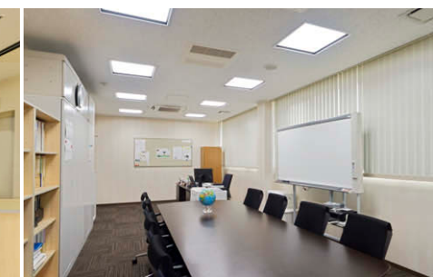
2階役員室の照明 TENQOOスクエア器具(5000K)⑤2階に設けた役員室、会議室、応接室にはスクエア器具を配置
