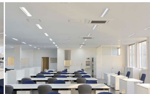
3階の事務室の照明 窓側は LED 器具+あかりセンサーによる昼光利用制御で明るさを一定に制御④
