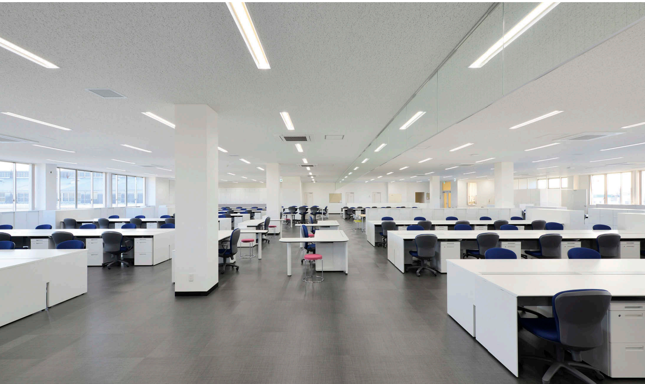
3階の執務室の照明 TENQOOシリーズ埋込形①②③を均等配置し、明るく快適な執務環境を創出
