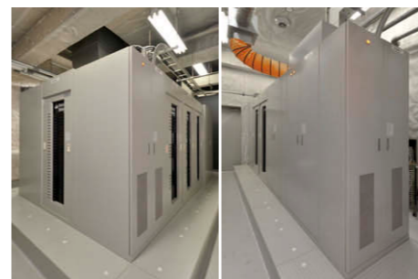
③を使用した大ホール用調光器盤 ④を使用した小ホール用調光器盤
