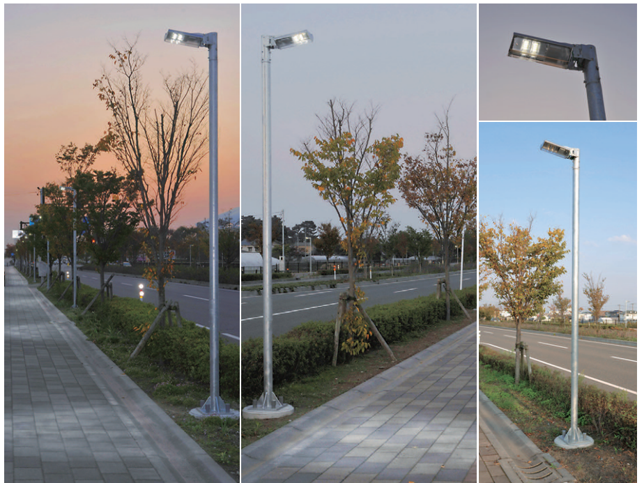
LED防犯灯が設置された市道弁天線側からスタジアム方向を望む、鳥屋野潟公園線の歩道照明 スタジアム方向から市道弁天線方向を望む、鳥屋野潟公園線の歩道照明 植込に設置されたLED防犯灯
