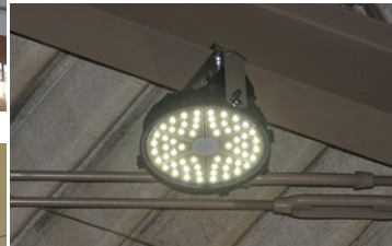
LED高天井器具取付状況
