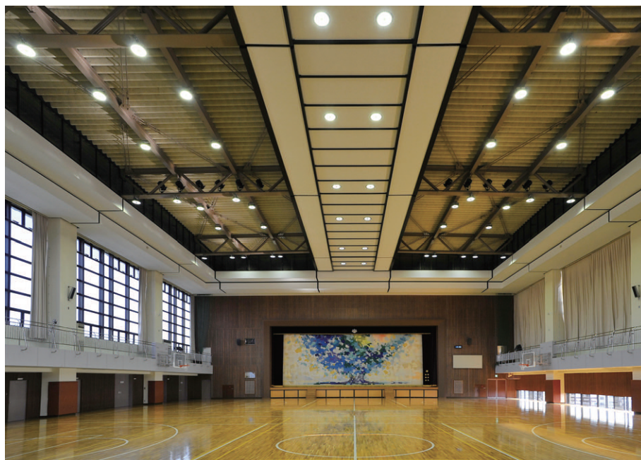
HIDランプ高天井用反射笠器具からLED高天井器具に更新し、同等以上の明るさを確保しながら大幅な省エネを実現。全点灯時の照明状況
