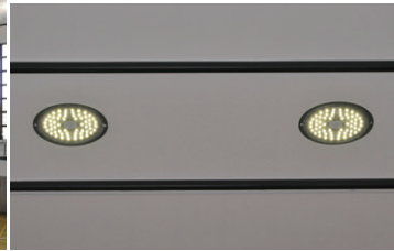
天井中央部に埋込設置したLED高天井器具
