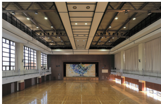
LED高天井器具に更新後の半点灯照明状況
