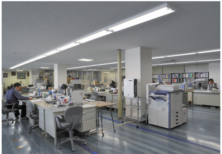
照明改修されたオフィスの出入口側から奥側を望む 既存のFLR110W2灯用器具からLEDベースライト直付下面開放器具に更新
