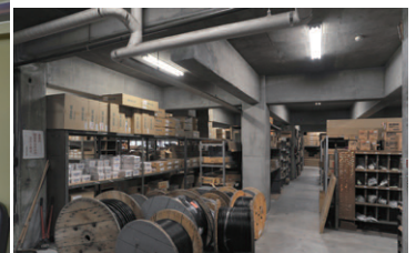
倉庫にはLEDベースライト逆富士器具を採用
