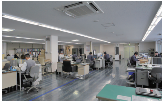
オフィスの奥側から出入口側へ更新のLEDベースライト直付下面開放器具を望む
