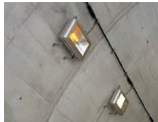
プレス型トンネル照明器具 Pressed-type tunnel lighting equipment 左側が基本照明(低圧ナトリウムランプ)、右側が入口照明(高圧ナトリウムランプ)
