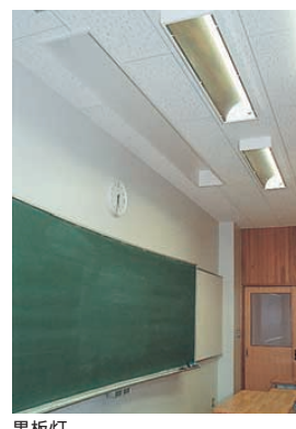
黒板灯 Blackboard light 直付の黒板灯を2台設置。照度ムラがなく、黒板の文字を読みやすい視環境が得られている
