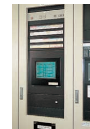
照明制御システム MESL-S主制御盤 Lighting control system, MESL-S main control plate
