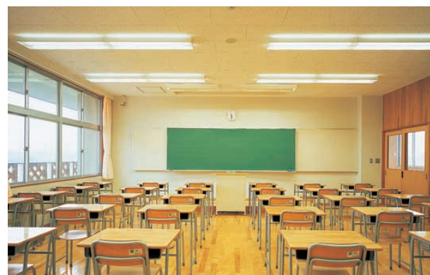
普通教室 Classroom スクールソフトの直付器具を2連結にして設置。まぶしさがなく、机上での読み書きに良好な明るさをつくり出している
