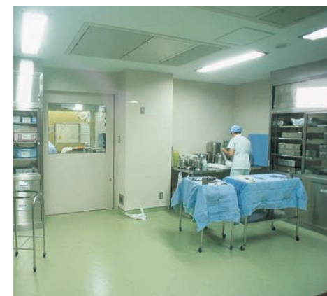
高出力形のクリーンルーム用器具を採用したクリーンサプライ室
