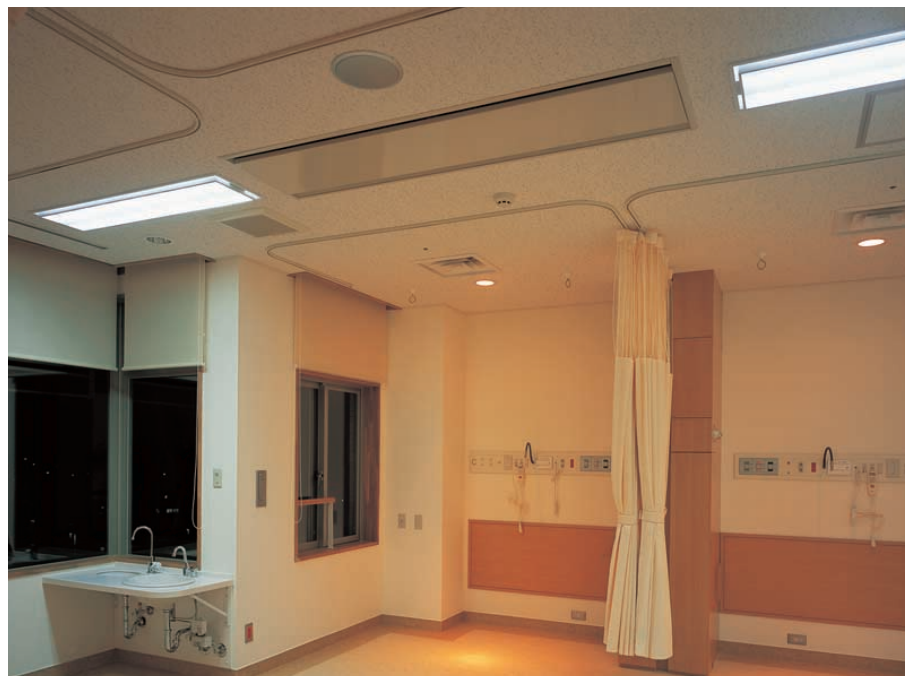
病室(4人部屋)の照明：ベース照明に32W Hf蛍光ランプルーバ付埋込病室用器具を採用し、処置灯には85Wハロゲンランプ照射角可変形ダウンライトを設置
