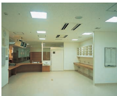
ナースステーションの照明：ベース照明にルーバ付の36Wコンパクト形蛍光ランプ3灯用スクエア器具を採用
