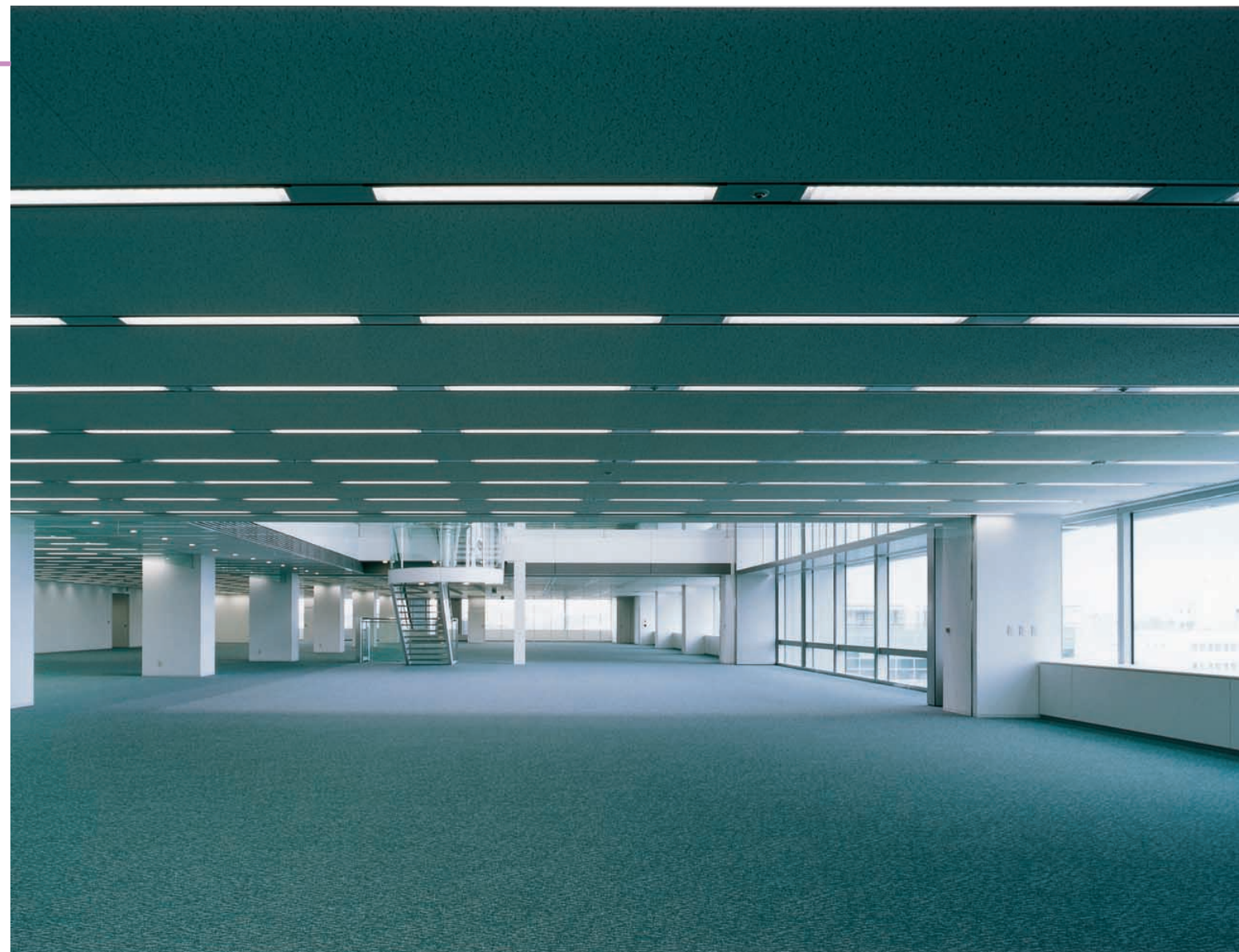
事務室の照明：システム天井に32WHf蛍光灯ランプ埋込器具を連結配置。照度センサーによる外光補正制御で、適正照度を得ながら省エネを図っている
