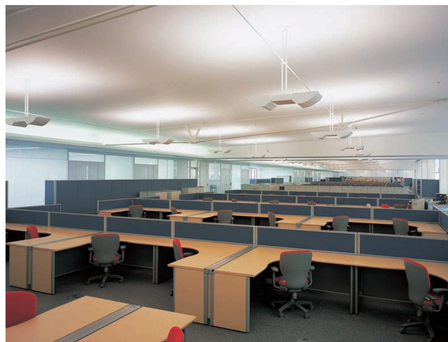
執務室の照明：アンビエント照明に150Wセラミックメタルハライドランプ2灯用特注アッパーペンダントを天井より吊り下げている
