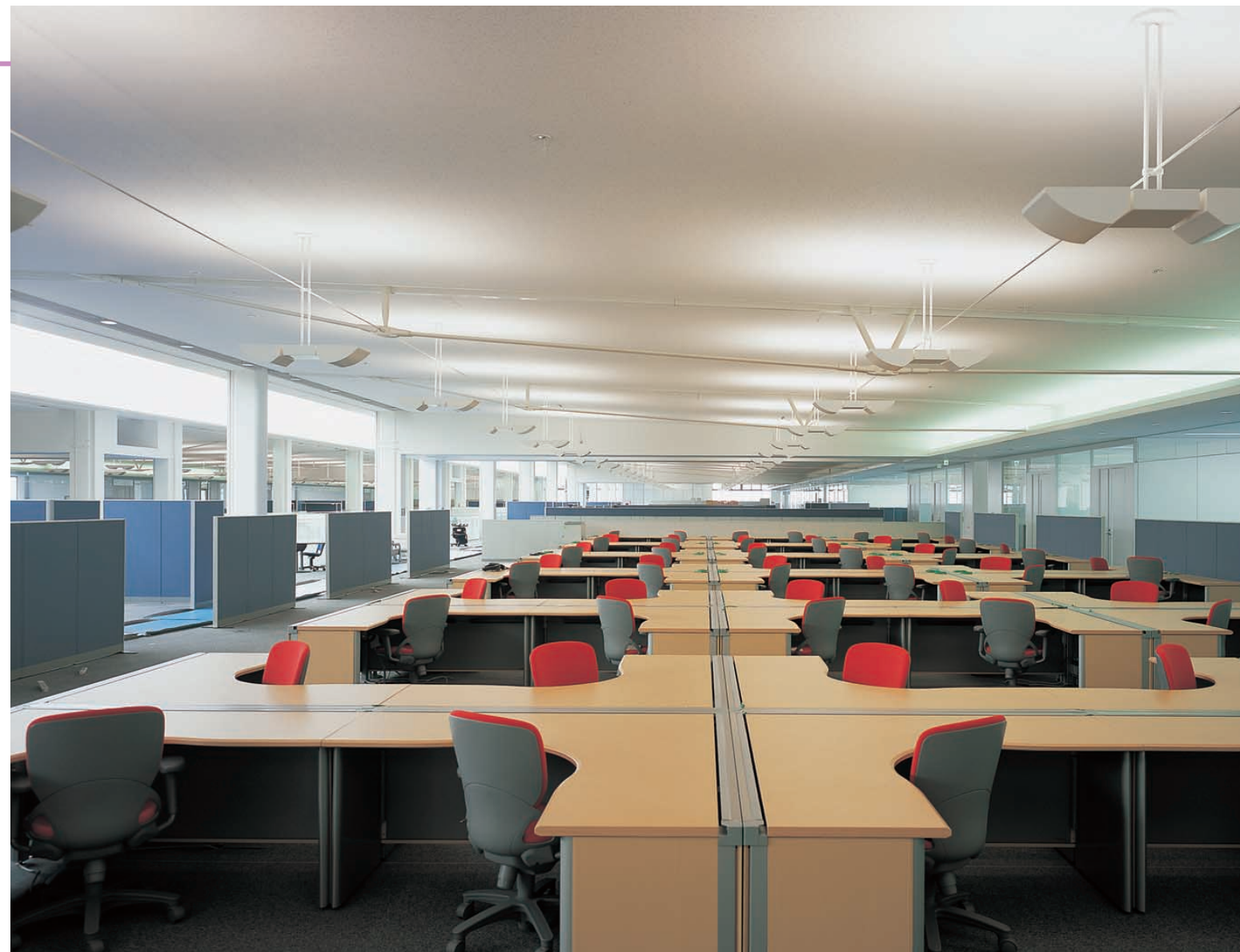
執務室の照明：アッパーペンダントの間接照明により、柔らかな光環境で空間に広がり感が得られており、かつ、高いフレキシビリティが実現されている
