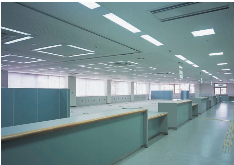
執務室の照明：32WHf蛍光灯1灯用ルーパ付埋込器具の連結を日の字配置。照度ムラの少ないほどよい照明環境を創り出している
