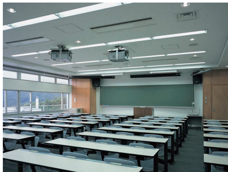
大教室の照明：32WHf蛍光ランプ1灯用埋込連結器具をライン配置。多用途の環境に合わせて最適な調光制御を可能にしている
