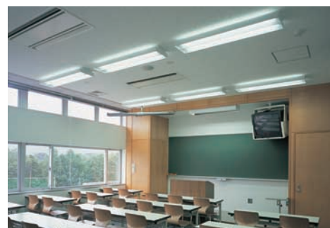
中・小教室の照明：クリアカット24の直付スクールソフトを採用。天井面にも光が回り、部屋全体をムラなく照明、快適な視環境を創造している
