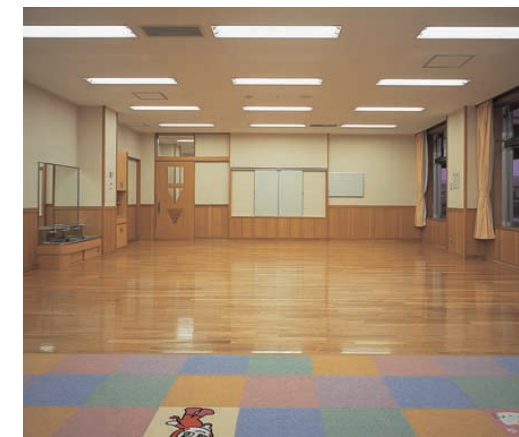
40W蛍光ランプ2灯用埋込器具を整齐配置した「ほふく室」の照明
