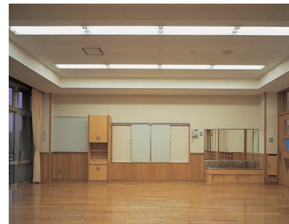
保育室の照明：40W蛍光ランプ2灯用埋込器具の連結設置によるライン配置で、明るく、安心感を高めた照明環境を創り出している
