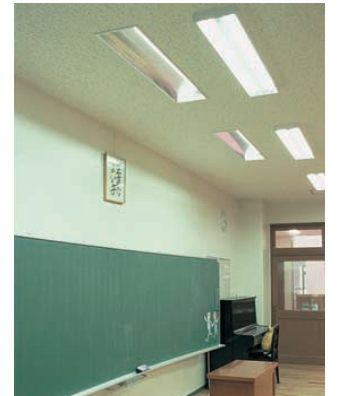
黒板灯には照射角切替可能形埋込器具を採用
