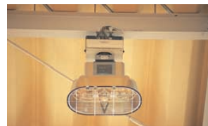
体育館の混光照明器具
