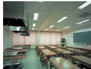
家庭科教室の照明：理科教室と同様の照明器具を採用
