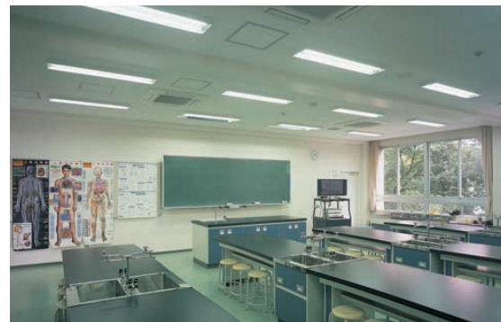
理科教室の照明：32WHf蛍光ランプ2灯用直付遮光角制御器具を採用
