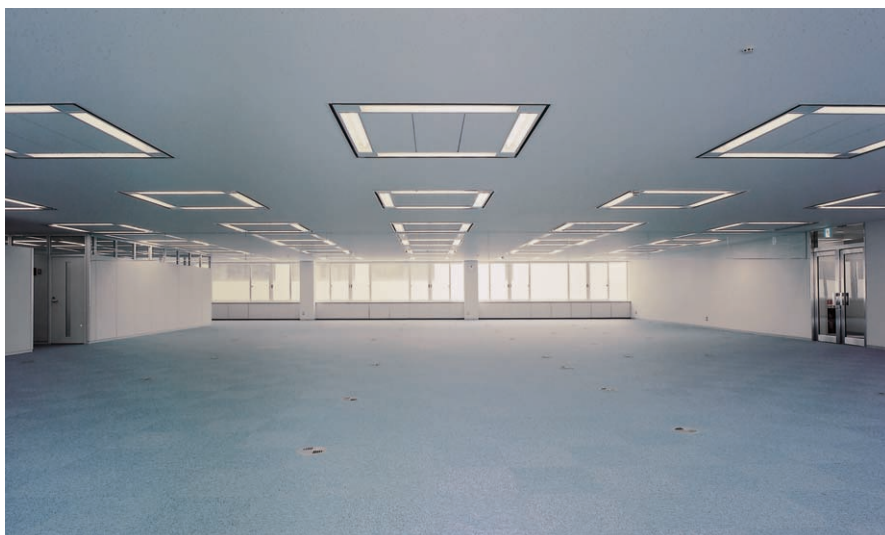
7階事務室の照明：32WHf蛍光ランプ口の字配置器具と照度センサーで初期照度補正制御、昼光利用制御を行う
