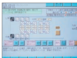
照明主制御盤 液晶画面
