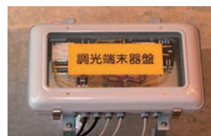
トンネル内に設置された調光端末器盤
