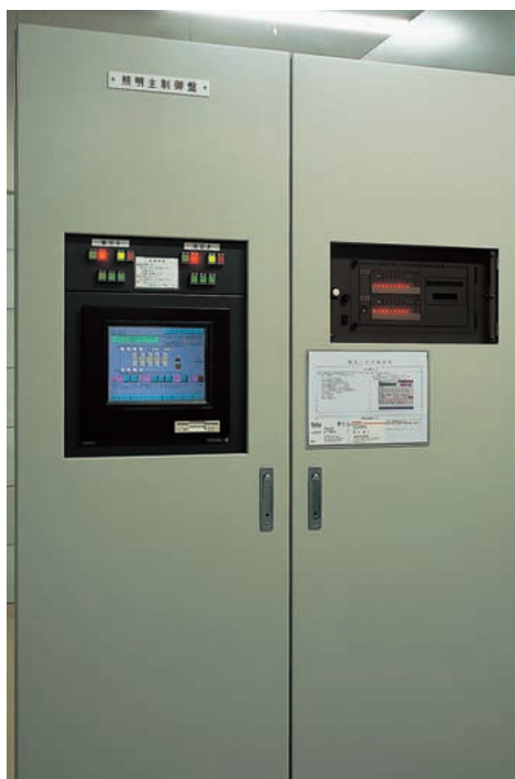
照明主制御盤 (神戸長田トンネル)
