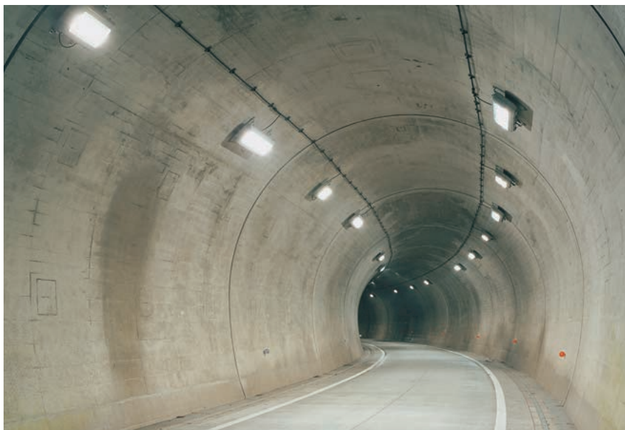
Hfコンパクト形蛍光ランプ トンネル照明器具が設置された恋路山トンネル
