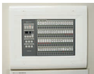
体育館全体を照明制御するリモコン操作盤
