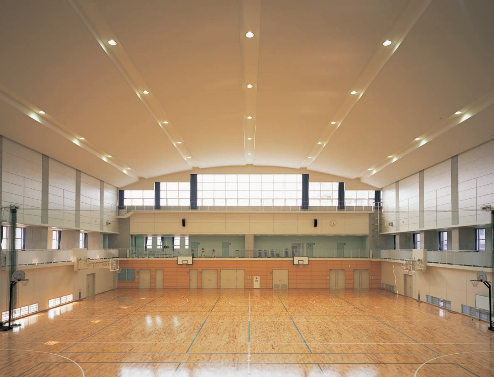
体育館大アリーナの照明：400Wメタルハライドランプ電動昇降装置付ダウンライトを天井スリット内に分散配置。適正な光環境を確保しながら省エネ・メンテナンスに配慮
